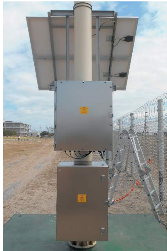
Ejemplo Instalacion Luxor IP67 en Suráfrica
