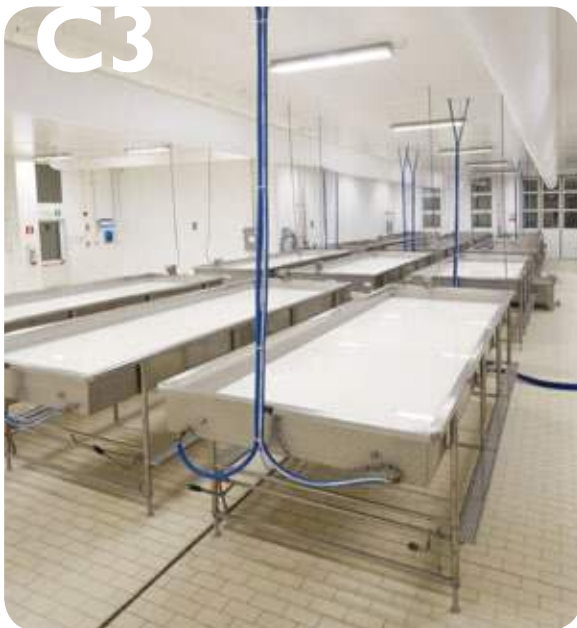
C3 - Industria alimentaria Plantas de proceso de alimentos, lavanderías,...
